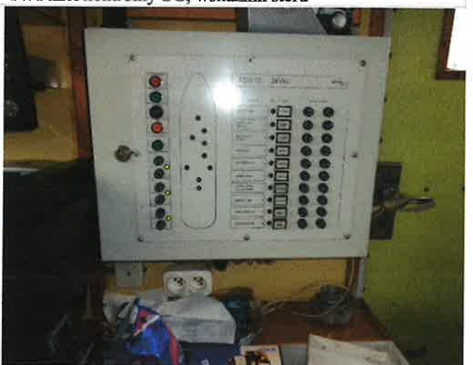
16. Rozdzielnica el. oświetlenia nawigacyjnego
