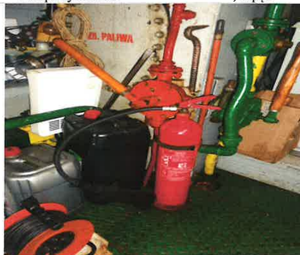
22. Ręczne pompy p.poż i wody morskiej
