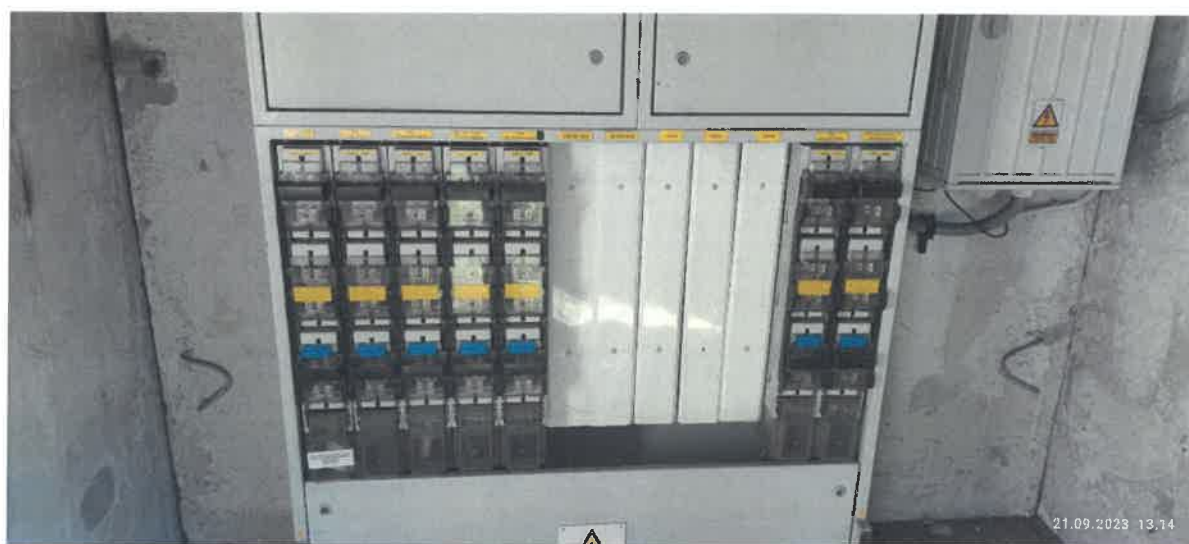
Zdj. 1 Zdjęcia istniejącej rozdzielniczy stacyjnej w stacji T-2066 CHRZANOWSKIEGO
