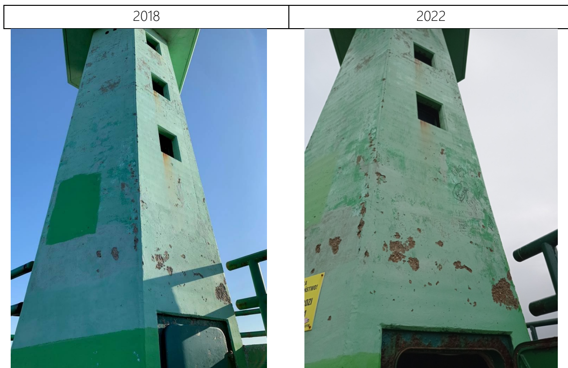
Fot. 1 Powierzchnia ścian latarni z powierzchniowymi ubytkami
