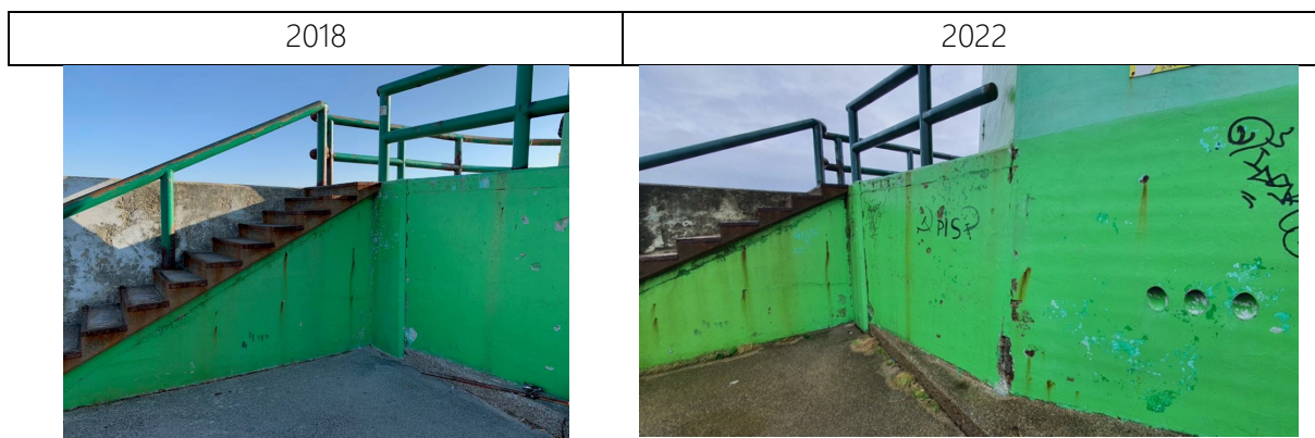
Fot. 3 Schody pomiędzy poziomami głowicy; widoczne skorodowane kątowniki na krawędziach stopni, zacieki korozyjne na betonie, pęknięcia uskoku pomiędzy poziomami
