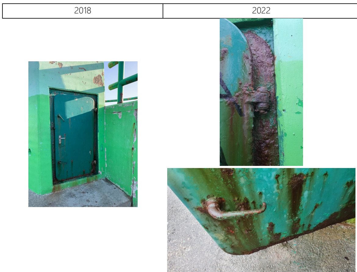
Fot. 2 Lekko skorodowane drzwi wejściowe i barierka; widoczne powierzchniowe ubytki betonu oraz pęknięcia powierzchni uskoku pomiędzy poziomami głowicy
