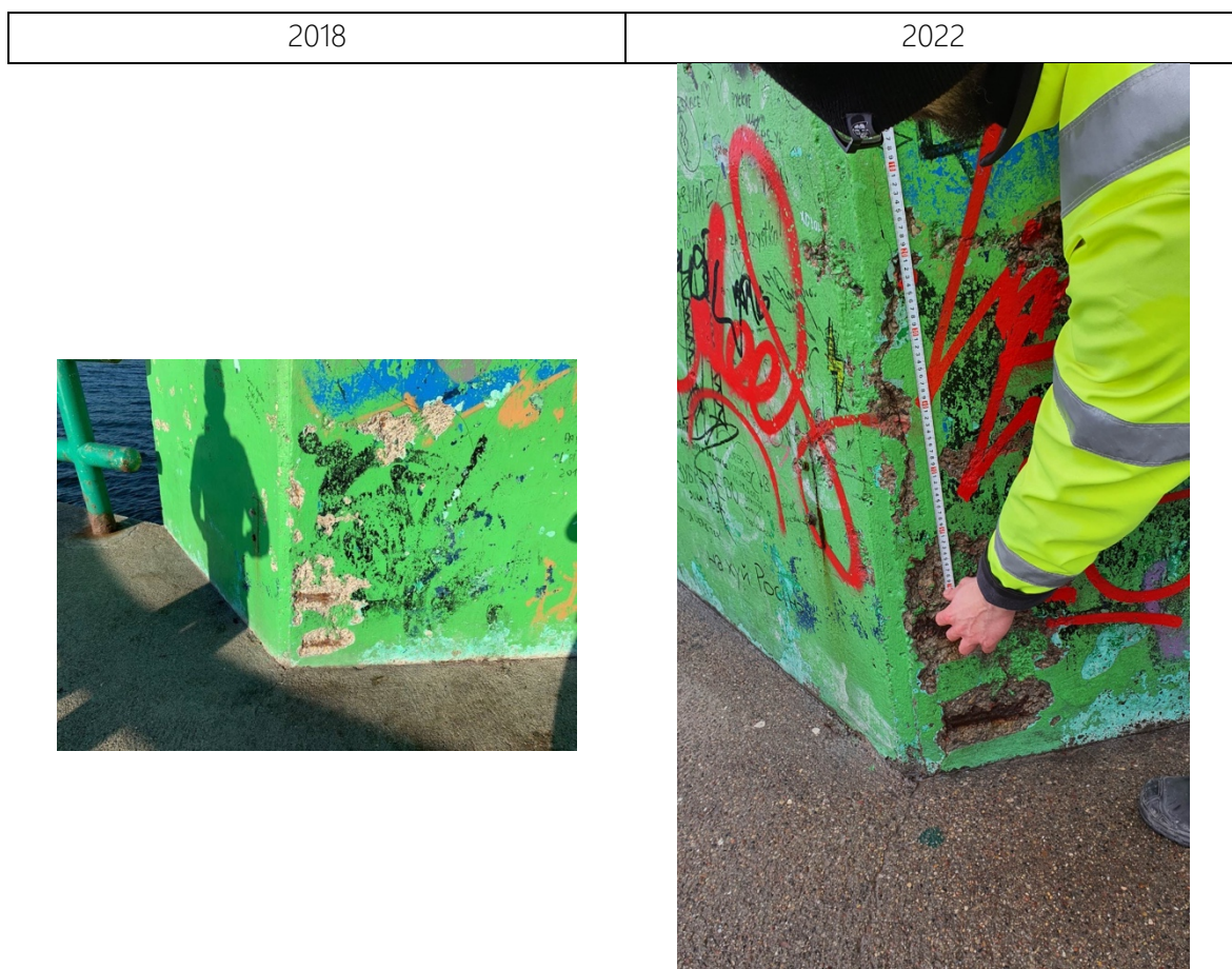
Fot. 5 Odsłonięte zbrojenie latarni; korozja na styku betonu i stalowej barierki
