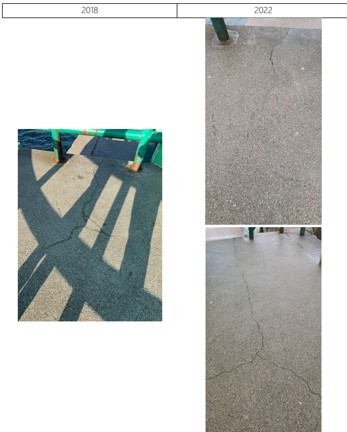
Fot. 4 Pęknięcie korony górnego poziomu głowicy
