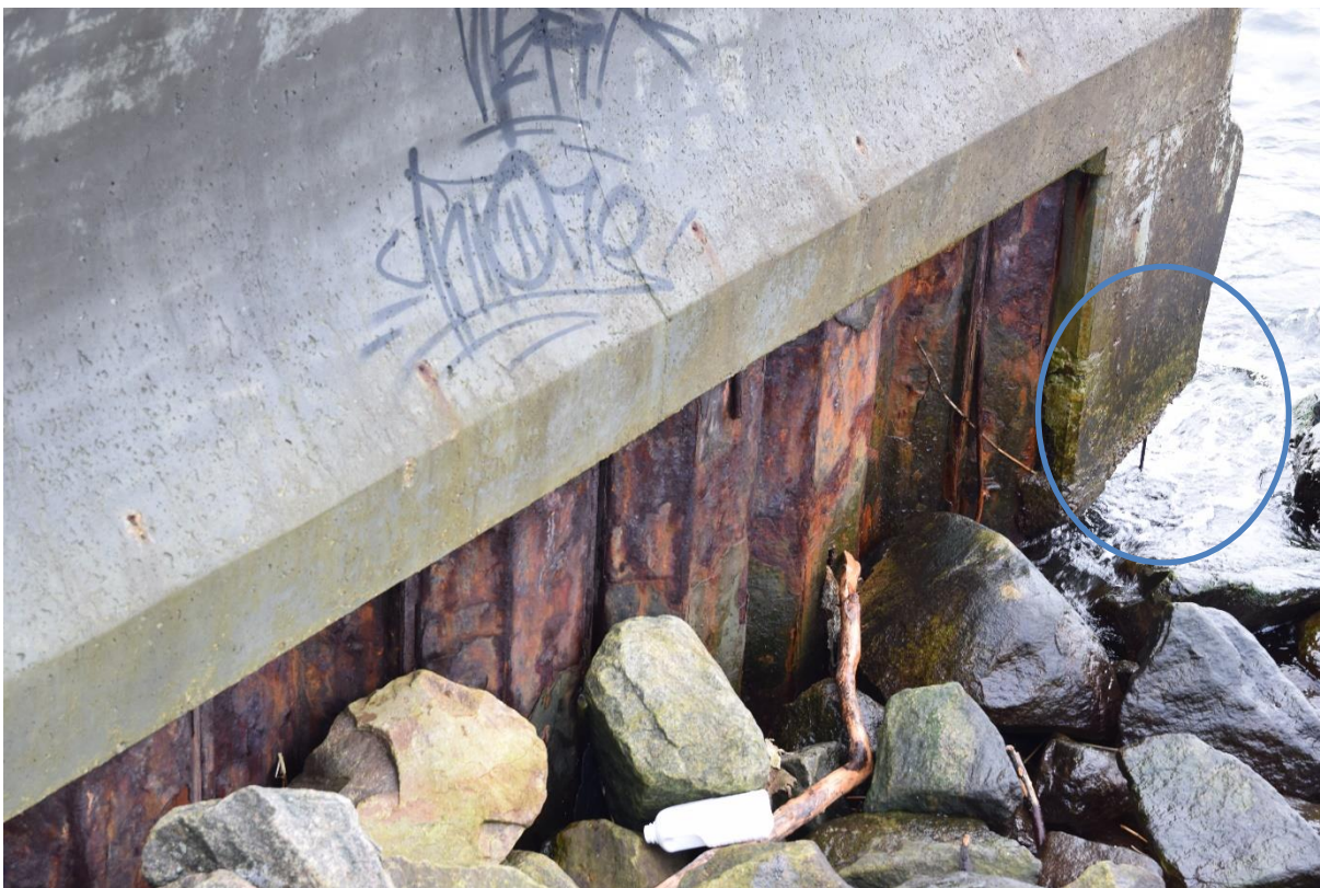
Widok ścianki od strony północnej. Ubytek betonu – widoczne zbrojenie – do naprawy.
