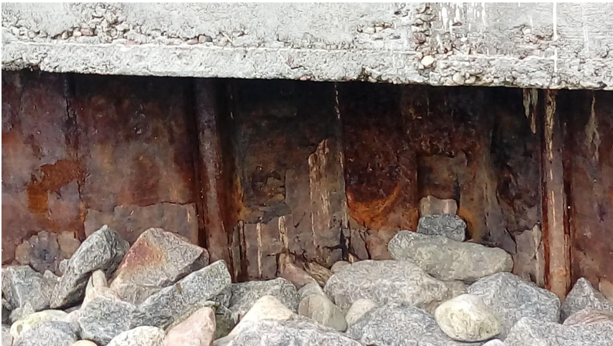
Widok ścianki od strony południowej – skorodowane grodzice stalowe.
